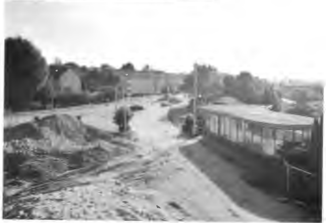
Hier entsteht ein Verteiler- kreis
